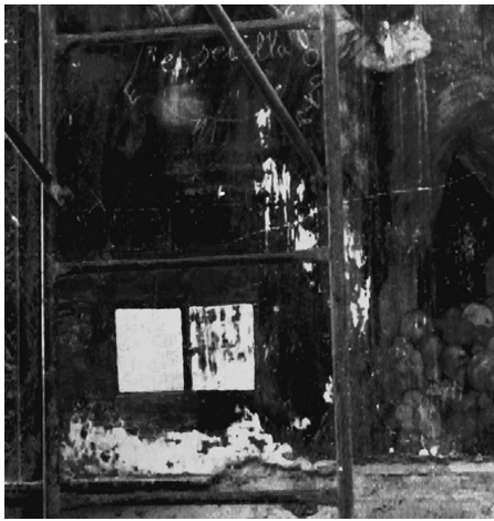
Fig. 31. Pruebas para estudiar el procedimiento que hiciese posible la separación de la pintura del muro.
